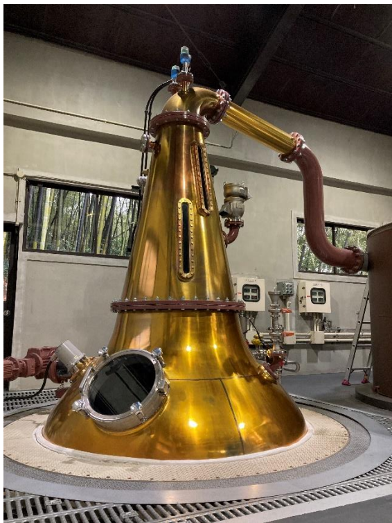
サントリー山崎蒸溜所内パイロットディスティラリー蒸溜釜
