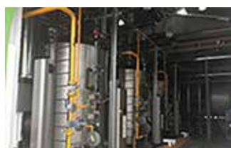
ビームサントリー Sauza（メキシコ） 工場 新設ボイラー
