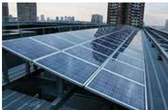
お台場オフィスの太陽光発電システム
