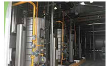
ビームサントリー Sauza（メキシコ）工場の 新設貫流ボイラー
