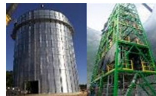
実証プラント
