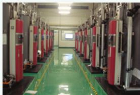
貫流ボイラー
